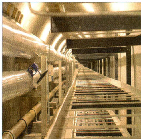
Horkovodní potrubí s izolací a uzavírací armaturou
